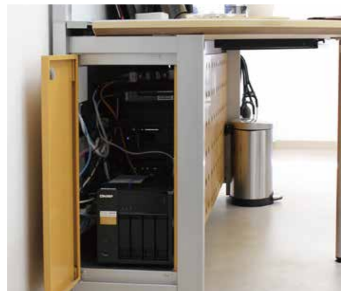
QNAP NASは診察室のデスク下のPC保管ラック内に収めている
