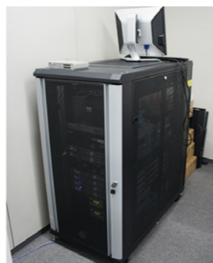
QNAP 製 NAS などの検証機が設置されているサーバーラック
