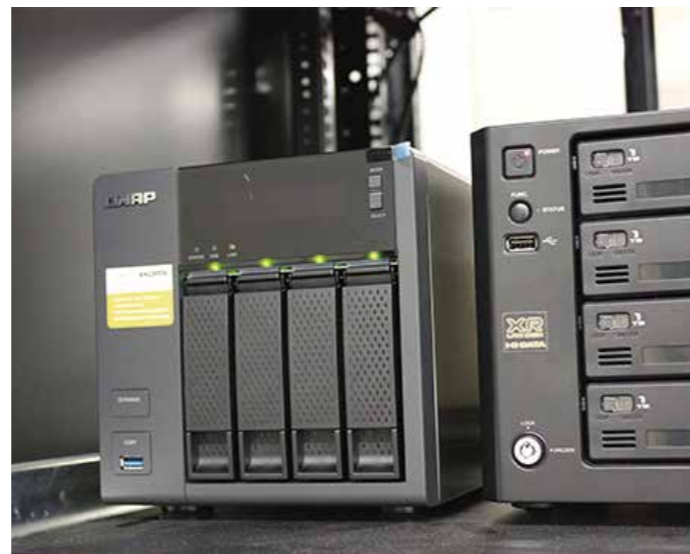
QNAP NASはサーバーラックの一角に収めている
